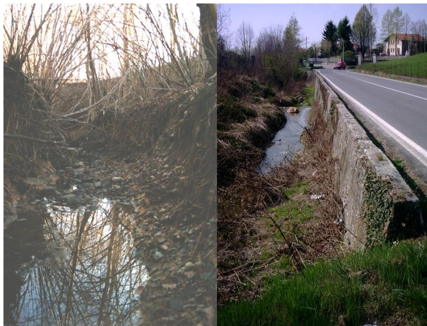
Foto 5: Sinistra: Rio di Pianezze a nord di S. Martino (quota 428 metri s.l.m.); altezza delle sponde 1.5 metri. Foto di ottobre 1999. Destra: Rio Pianezze a valle della Fornace: muro in calcestruzzo in sponda destra opera STRIDS008
