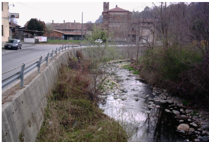
Foto 3: Muro di in calcestruzzo in sponda sinistra del Torrente Malesina presso Preparetto (opera STRIDS007)
